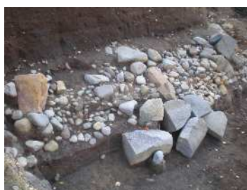
本丸西土塁埋門櫓台石垣崩落状況
