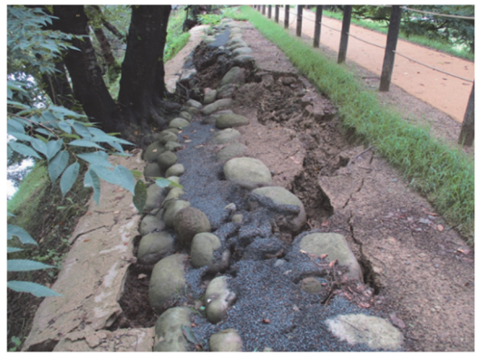
ニノ丸東土塁天端（土塀礎石列）き損状況
