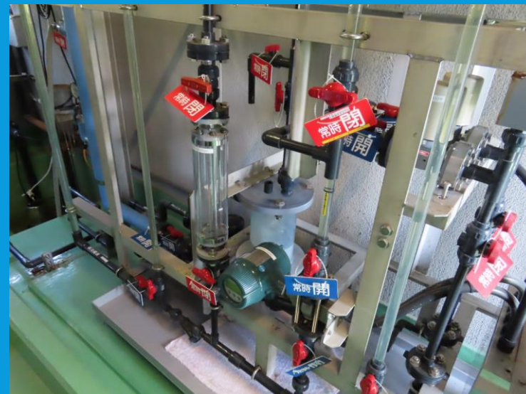
消毒設備（薬品注入）
