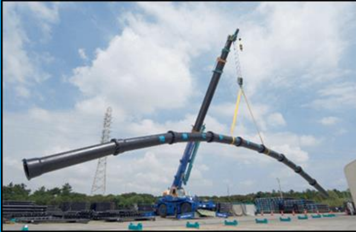
地震が起きても水漏れしない管
