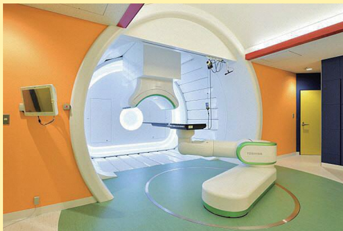
▲山形大学医学部「東日本重粒子センター」回転ガントリー照射室
