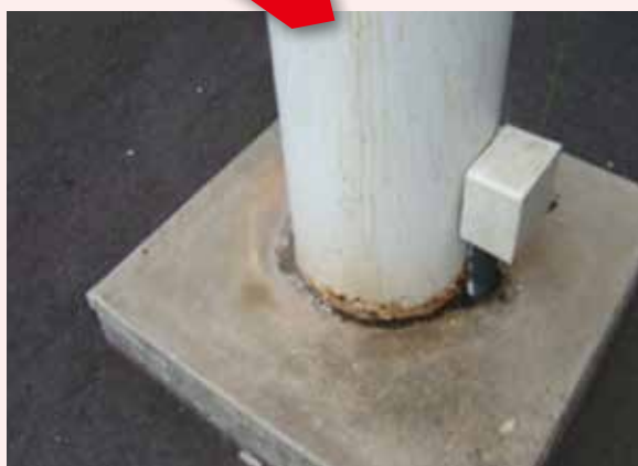
ポールの根元にサビが発生
