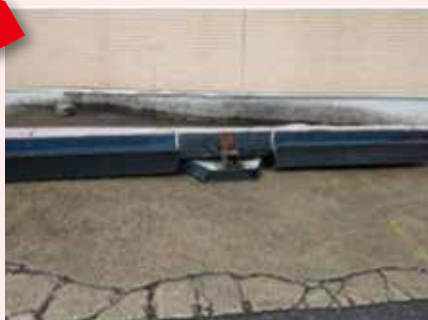
落下した欄間看板
