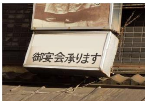
屋外広告物本体の傾き
