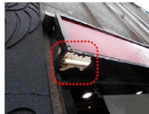
広告板底部の腐食
