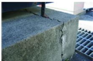
基礎部にひび割れ
