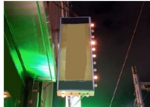
照明の一部不点灯
