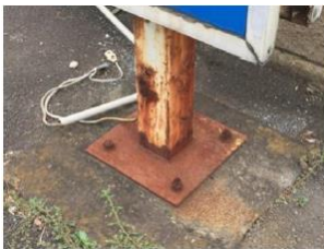
支柱、ベース、アンカーの錆び
