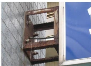
ブラケット・取付部の腐食
