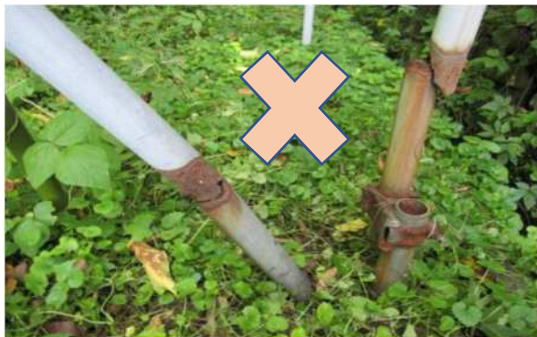
さびて折れたパイプ、さびたクランプ
