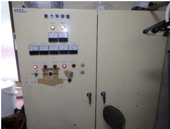
写真 23. 動力制御盤 (監視室内)
