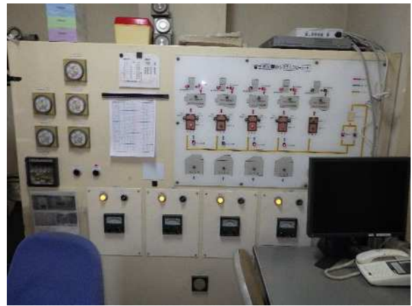
写真 22. 火葬システム (監視室内)
