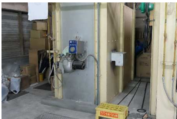
写真 15. 胞衣炉（機械操作室内）
