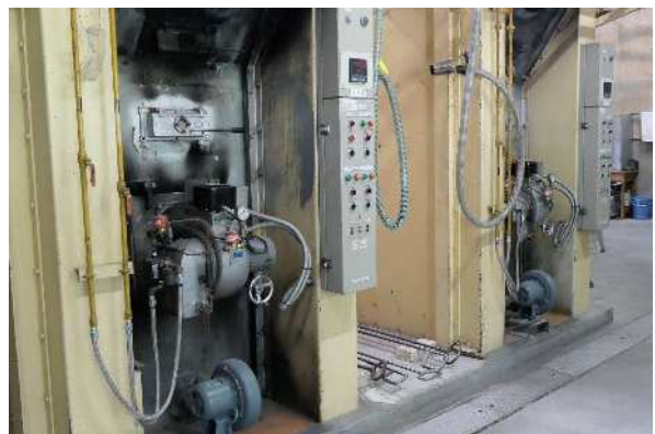
写真 14. 1・2号火葬炉（機械操作室内）
