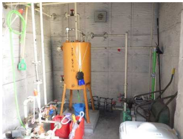
写真 25. オイルサービスタンク (機械室内)
