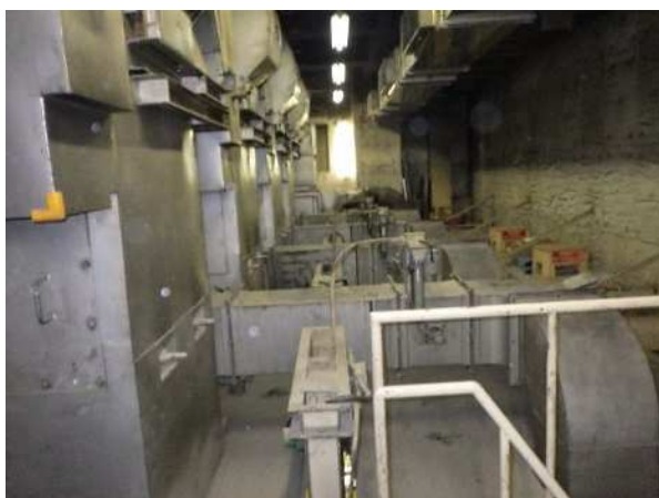
写真 19. 火葬炉排煙設備 (1~5号機)
