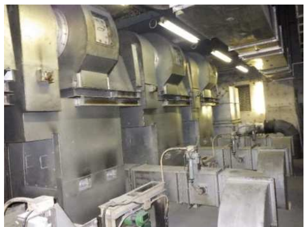
写真 20. 火葬炉排煙設備 (1~5号機)
