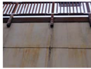
外壁破損及び室内漏水
