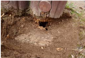
木製遊具の地際腐食
