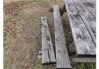
木材腐食による破損
