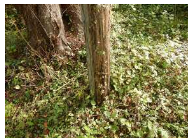
照明灯の木製支柱の腐朽
