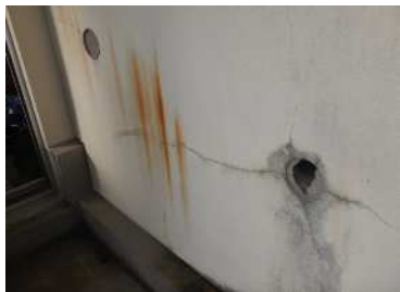
外壁にクラック
