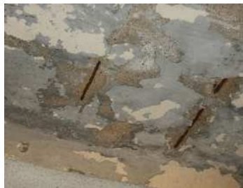
天井の鉄筋露出
