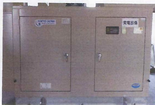
非常用電源装置
