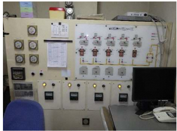
写真 22. 火葬システム (監視室内)
