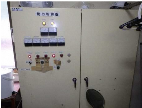
写真 23. 動力制御盤 (監視室内)
