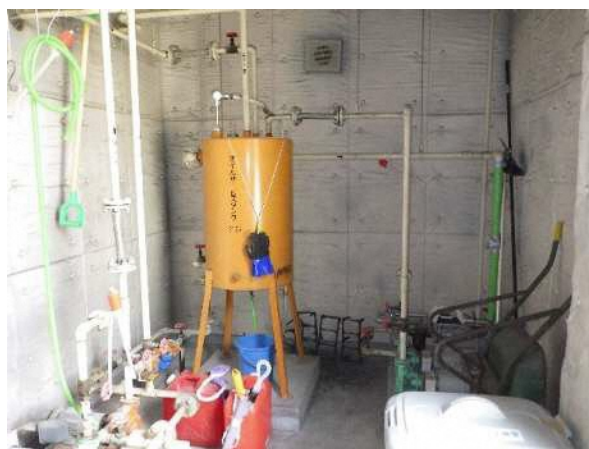
写真 25. オイルサービスタンク (機械室内)
