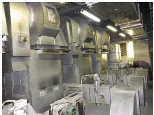
写真 20. 火葬炉排煙設備 (1~5号機)
