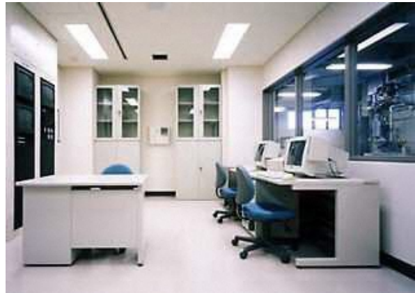
制御室（牛久市 うしくあみ斎場）
