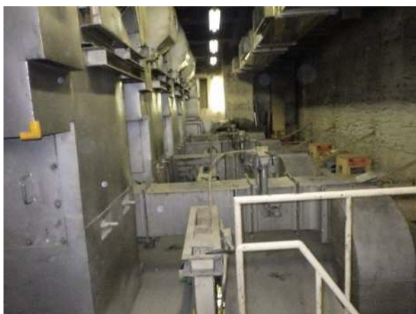
写真 19. 火葬炉排煙設備 (1~5号機)
