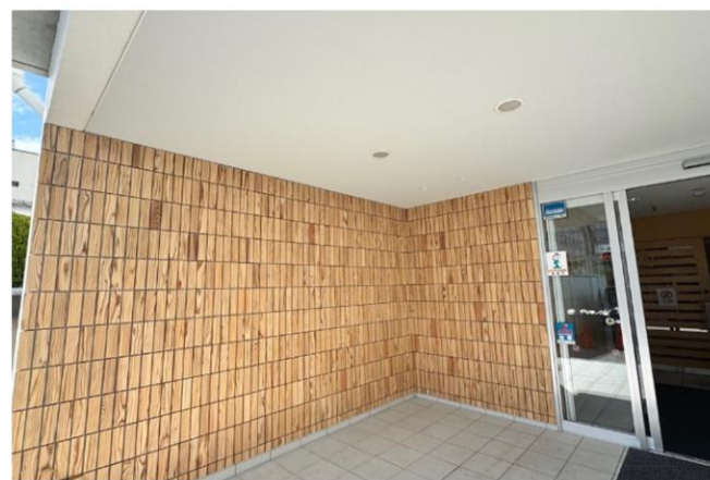
エントランスの一部に使用
