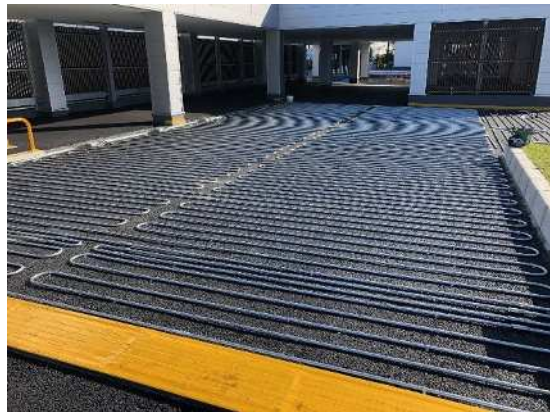
エネルギー回収施設立谷川に設置されたロードヒーティング
