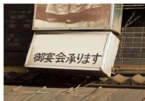
屋外広告物本体の傾き
