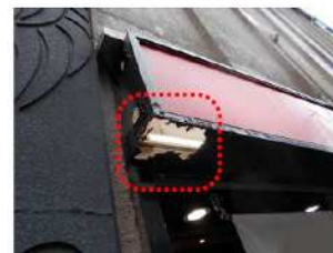
広告板底部の腐食
