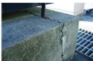
基礎部にひび割れ
