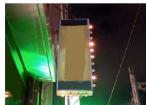
照明の一部不点灯
