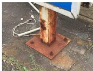
支柱、ベース、アッカーの錆び
