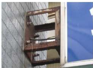
ブラケット・取付部の腐食
