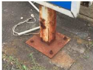
支柱、ベース、アンカーの錆び
