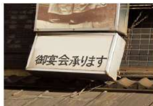
屋外広告物本体の傾き
