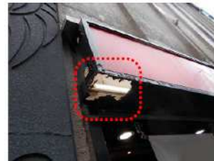
広告板底部の腐食
