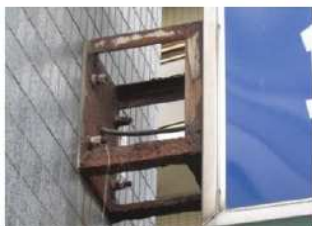
ブラケット・取付部の腐食
