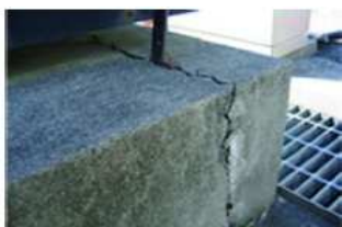
基礎部にひび割れ
