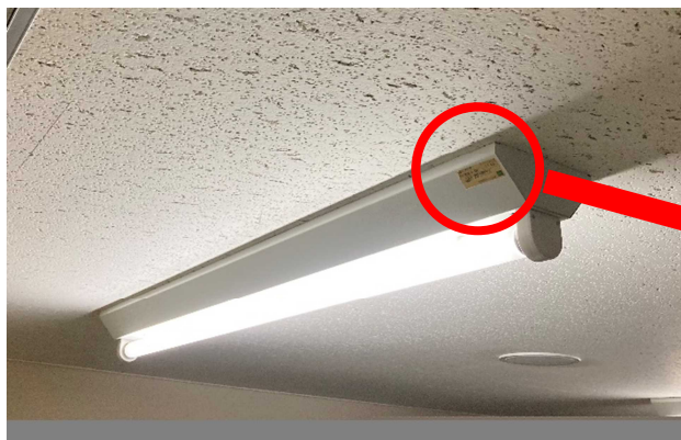
(↑蛍光灯照明器具)
