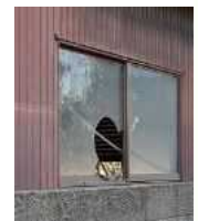
窓が割れた管理不全空家
