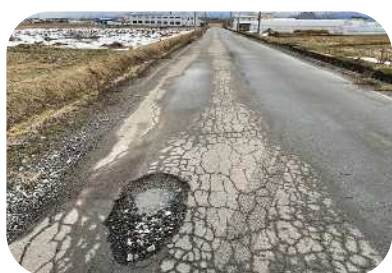
道路の通報例
