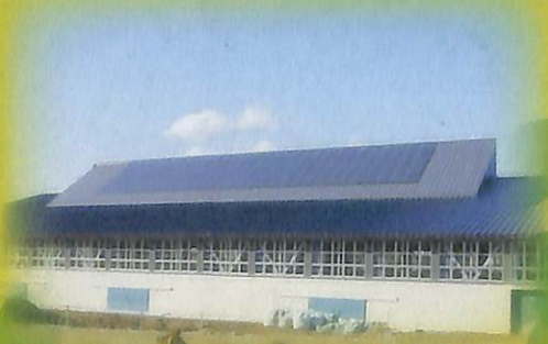
屋内多目的コートの屋根には大きな ソーラーパネルがついていて、たく さんの電気をつくっています。
