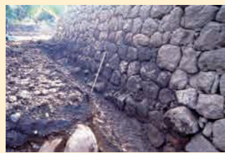
江戸時代の石垣崩壊痕跡 (石垣のせり出し)
