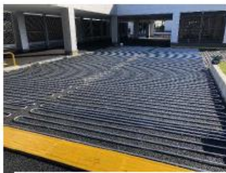
エネルギー回収施設立谷川に設置されたロードヒーティング
