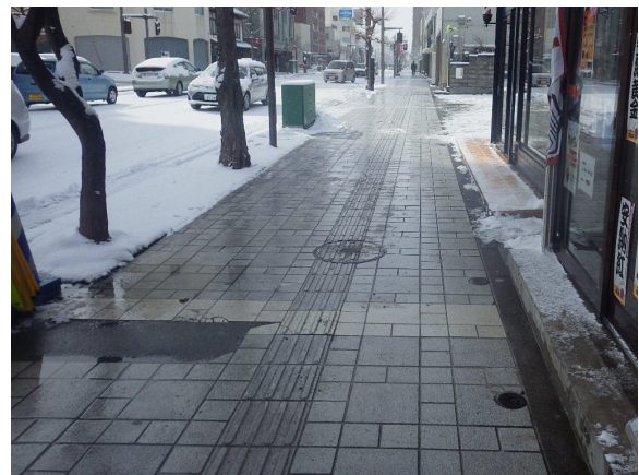
地下水熱による無散水消雪道路
