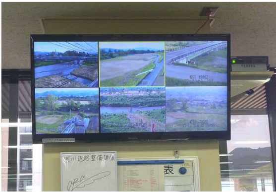
写真上：河川道路整備課内に設置してあるモニター
