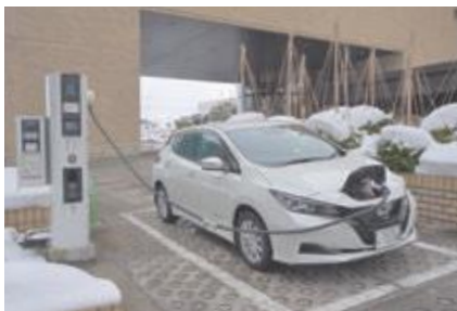
▲脱炭素の流れにより急速に普及が進むと言われるEV車や関連設備
