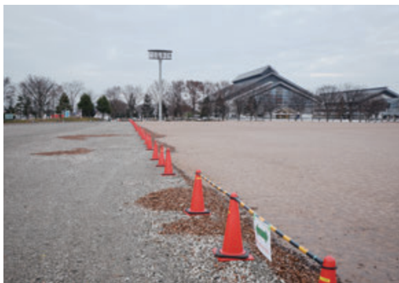
▲全長150mの防球ネットが設置される多用途広場
