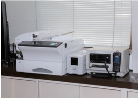
▲防災支部に配置された防災無線
