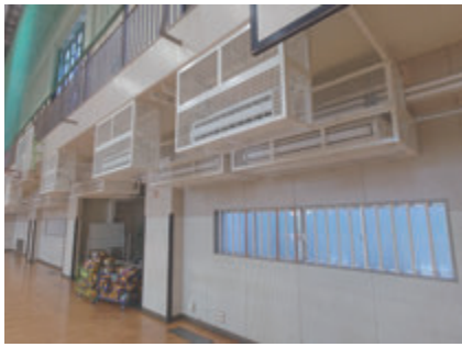
▲船橋市が整備した体育館の空調設備
