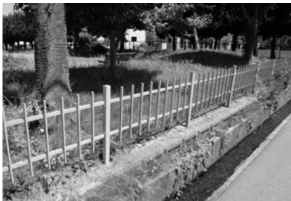
▲安全を強化するためフェンスの更新を予定している小立公園
