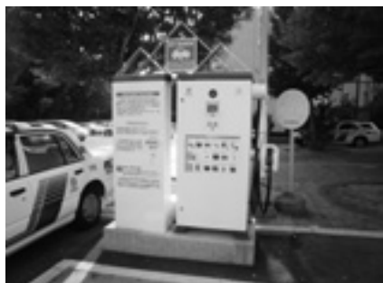
▲県庁に設置されている電気自動車充電設備
