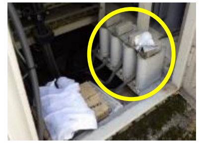
キュービクル内に残置された廃コンデンサー
